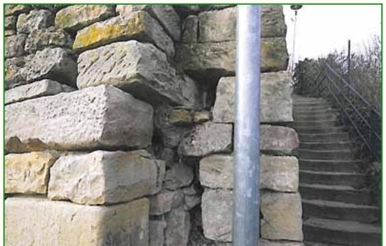
Die Trockenmauer versagt bald
