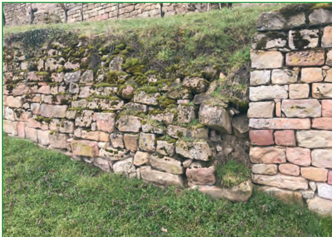
Die einsturzgefährdete Stützwand vor der Sanierung
