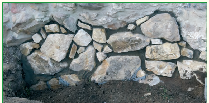
Ringmauer Untermauerung im Bereich des fehlenden Fundaments
