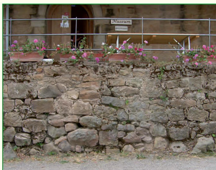
Die sanierungsbedürftige Mauer vor der Bühne
