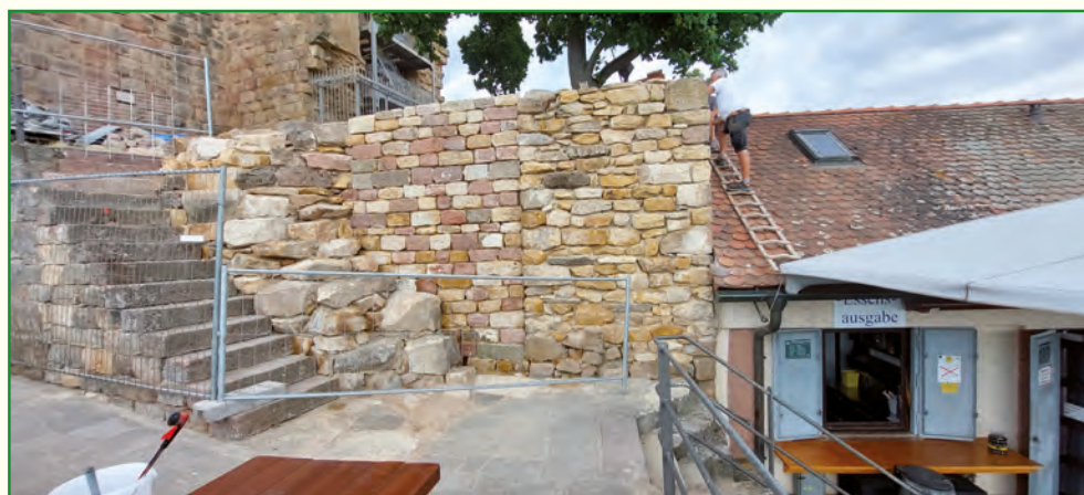
Sanierte Mauer hinter der Burgschänke, die rötliche Mauer in der Mitte ist zum Teil als Trockenmauer ausgeführt.
