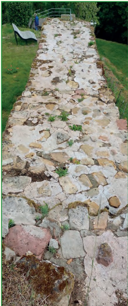
Foto 2: Die geschädigte Mauerkrone
