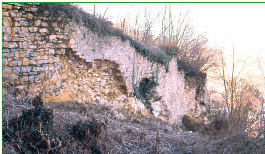
Foto 3: So wie 1988 würde die Mauer wieder in ca. 15 Jahren aussehen
