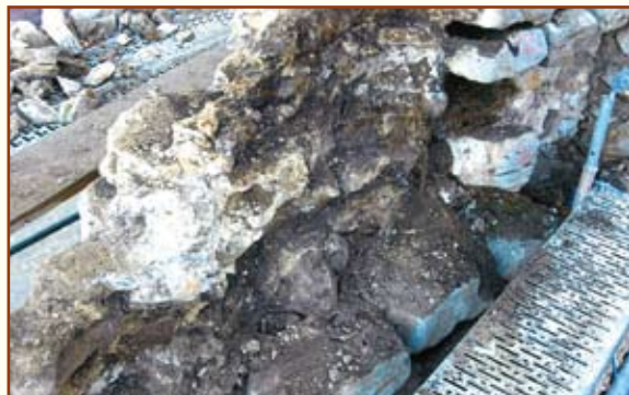
Bild oben: Der Kronenbereich besteht nur noch aus Schuttmassen
