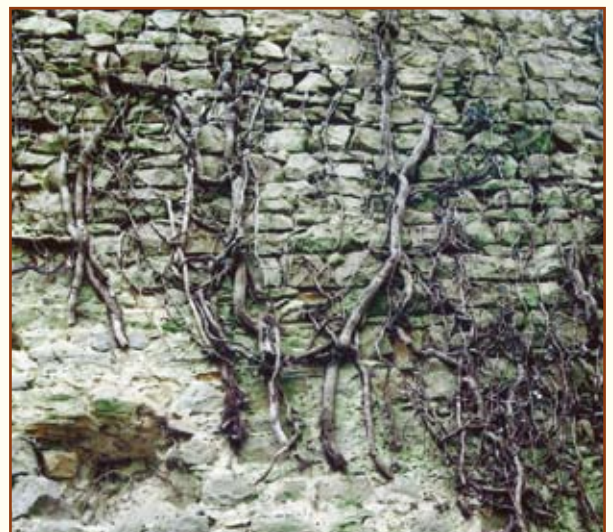
Armdick Efeustränge mussten entfernt werden.
