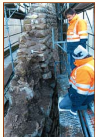
Bild links: Die westliche Vorburgmauer vor der Sanierung
