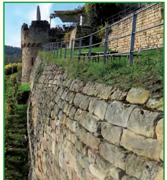
Einsturzgefährdete Ringmauer zwischen Süd-Ost- und Ostturm
