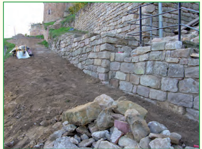
Auch diese kleine Wand musste erneuert werden, da sie durch den Einsturz der Stützmauer auch beschädigt wurde
