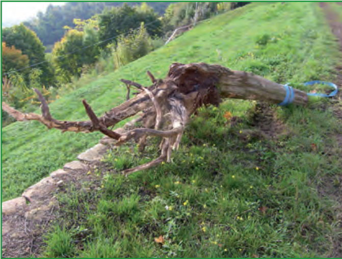
Auch die Baumwurzel hat zum Einsturz der Mauer beigetragen
