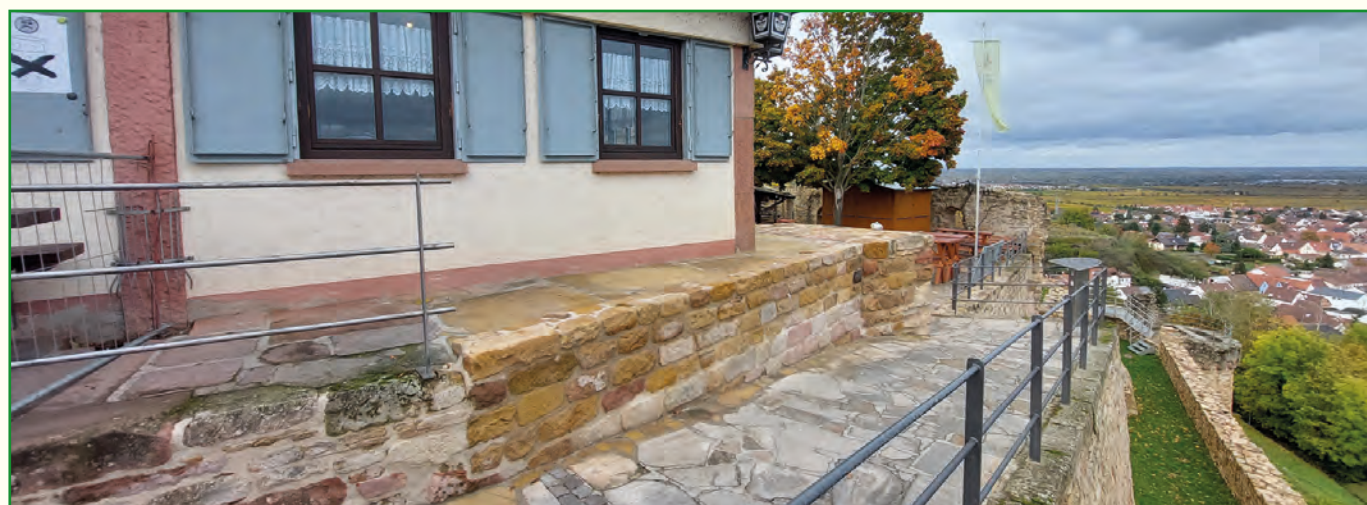
Nicht historische Mauer parallel zur Gaststätte - Fotos: Förderkreis Wachtenburg
