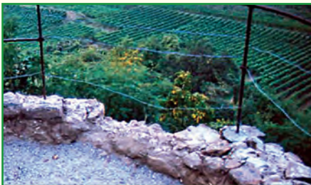
Foto 1: Der Turm war nur mit verrosteten Drähten gesichert. Foto: Förderkreis Wachtenburg der Pfähle bestand zudem aus mehr oder weniger verrottetem Holz. In einem ersten Schritt er-
