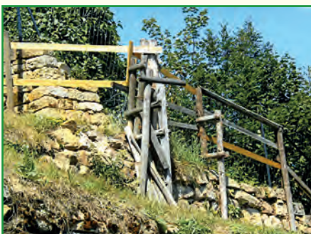
Foto 2: Ein notdürftig gesicherter Fußweg mit einem Holzgeländer, welches immer wieder zerstört wurde. Foto: Förderkreis Wachtenburg
